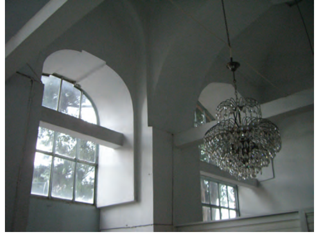
Bursa Selçuk Hatun Cami sonradan kapatılmış revak bölümü
